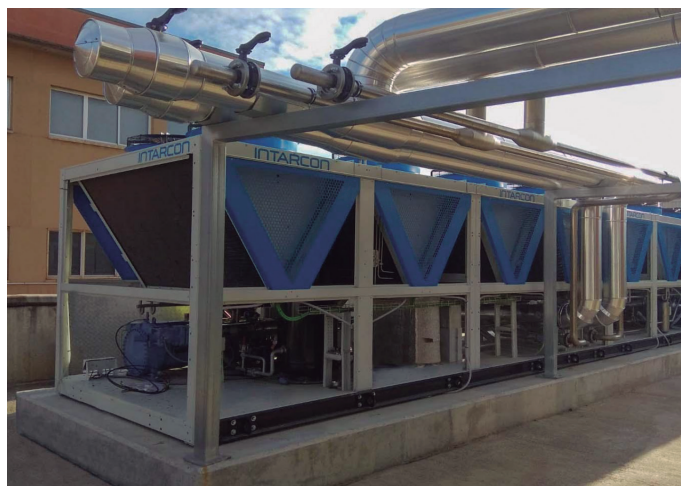
> Planta enfriadora de glicol Ammolite de 750kW de potencia frigorífica con tecnología de baja carga de amoníaco. Fuente INTARCON.
